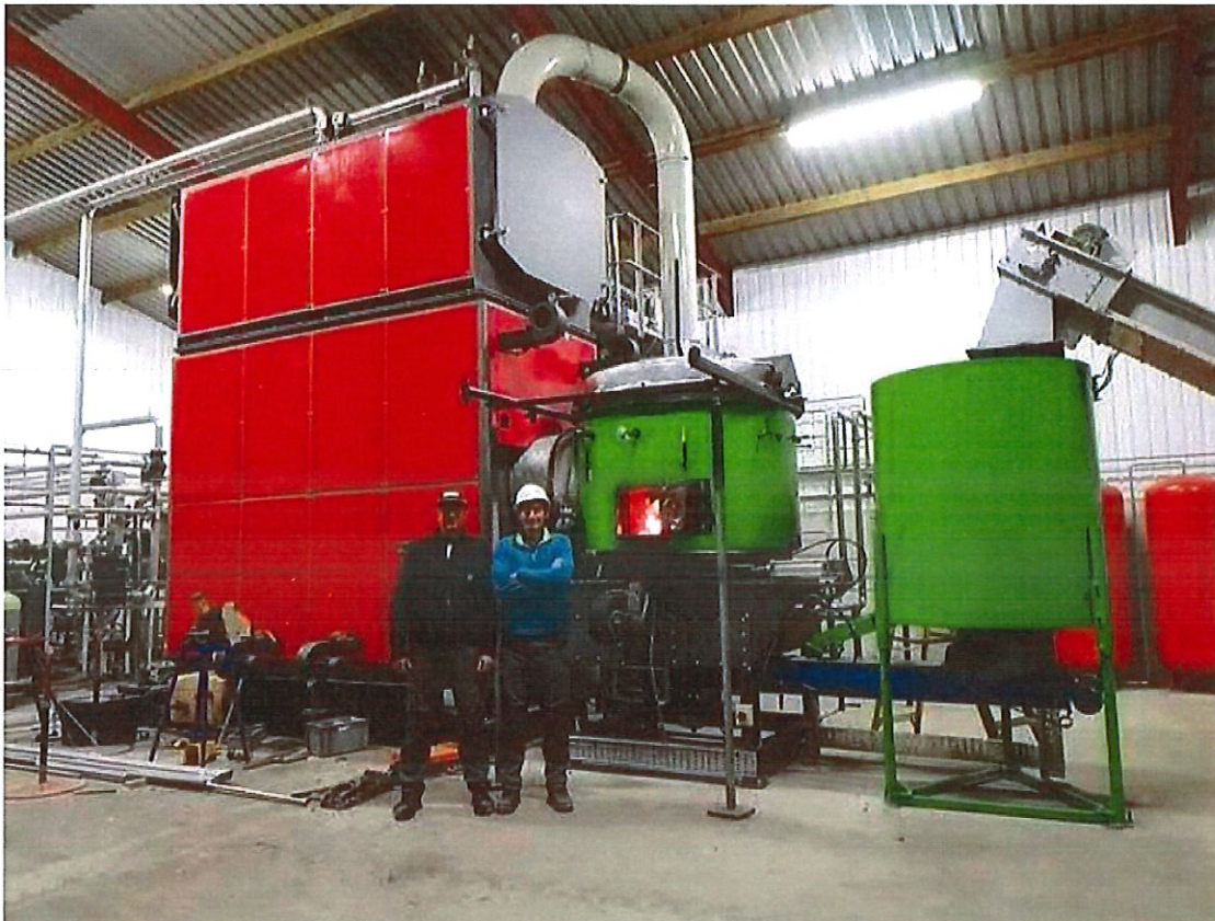
La société galloise Woodtek Energy, spécialiste des chaudières biomasse et des sècheurs, avait commandé à Mini Green Power une centrale verte de 750 kWth. (Photo D.R.)
