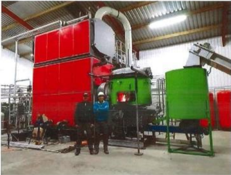
La société gironde Woodtek Energy, spécialiste des chaudières biomasse et des sécheurs, avait commandé à Mini Green Power une centrale verte de 100 kWth. (Photo: M. R.)
