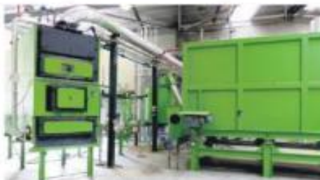
La centrale recycle des végétaux pour produire de l'énergie.
