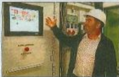
Point de contrôle d'une mini centrale.
